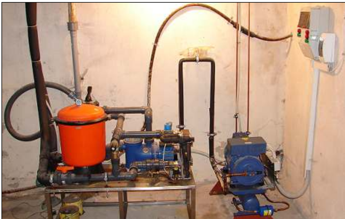
22 pav. Vandens atvėsinimo įranga
